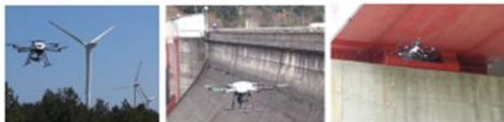
風力発電機の点検 ダムの点検 高層部の写真撮影による状況確認 ※安全対策として、機体に自律制御や強制帰還が搭載され、また社内で運転基準を設けて運用しています。
